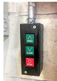
Activation par d'ouverture/fermeture/arrêt
